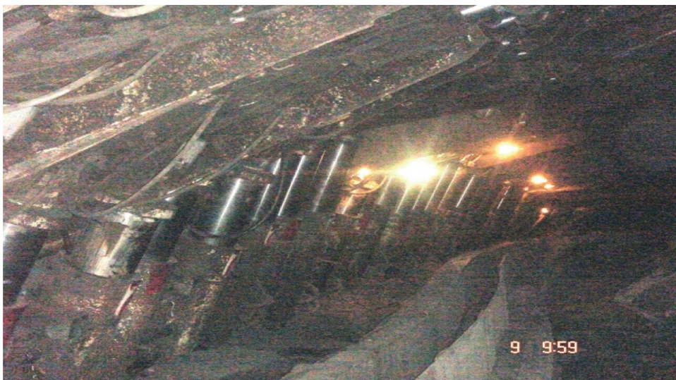
Рисунок 5 – Действующая эксплуатация СМК: СМК наклонены на забой, поддерживающие и оградительные элементы находятся на одной линии или в одной плоскости, поддерживающая способность утрачена (отсутствует)
