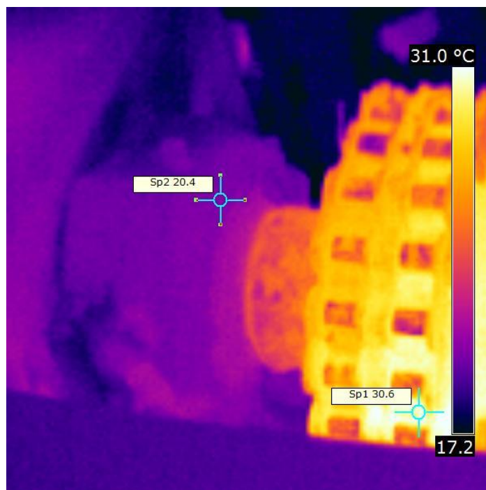
Рис. 4. Дефекты зубчатой муфты
