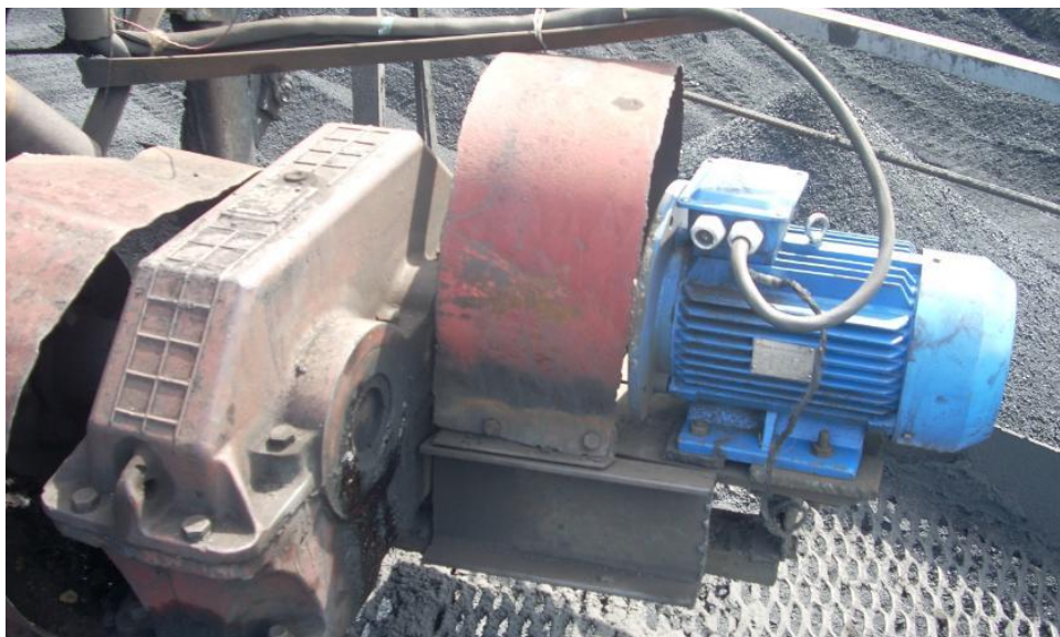
Рис. 1. Общий вид привода ленточного конвейера Л-650 Fig. 1. General view of the L-650 belt conveyor drive
